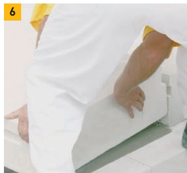
6. Dílec ukládáme s mezerou cca 10 mm od sousedního dílce pro vytažení popruhu. Použijeme-li montážní kleště, lze panely pokládat na sraz.
