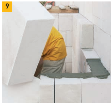
9. Zasazení rohového stupně, který je „zazděný“ do schodišťového zdiva a podezděný u nosné obvodové zdi.
