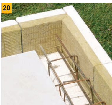
20. Do mezery mezi dílce a věncové tvárnice vložíme výztuž budoucího věnce, který je v úrovni stropu a zpevňuje celou stavbu.
