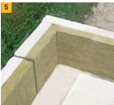
5. Mezera mezi stropními dílci a věncovými tvárnici slouží k vytvoření věnce v úrovni stropu, který obíhá kolem celé stavby.
